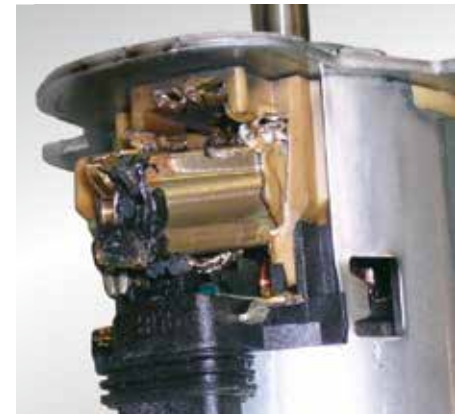
Schadensbild: Schmelzspuren am Elektromotor oder an den elektrischen Kontakten
