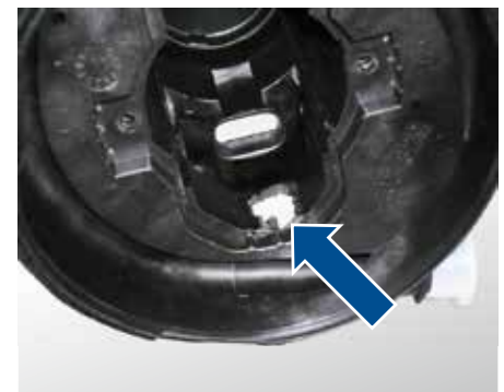
Schadensbild: Schmelzspuren am Gehäuse (Blick von oben in das Gehäuse)
