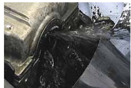
Achtung: Bei einer einwandfreien Schmierölaufuhr können hier 30-60 Liter pro Stunde fließen.
