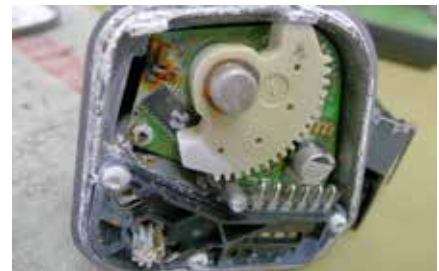
Blick in das Innere einer beschädigten Regelklappe
